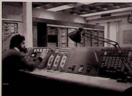
Bild 3: Zentraler Prüf- und Meßplatz für die gesamte Sendeanlage von Norddeich Radio (Foto: Zeitbild)
